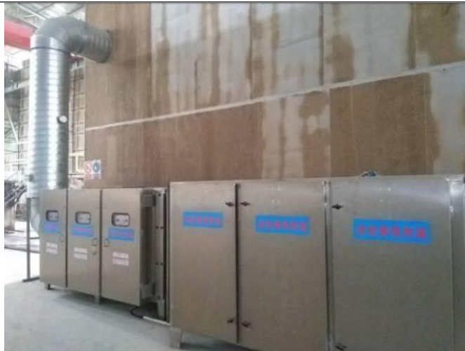
浸涂、晾干工序废气治理设施
