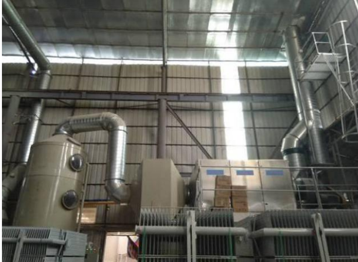
固化工序废气治理设施
