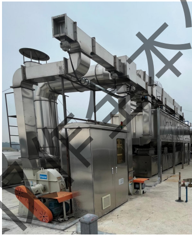
电泳车间废气治理设施 S2
