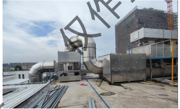
电泳车间废气治理设施 S2
