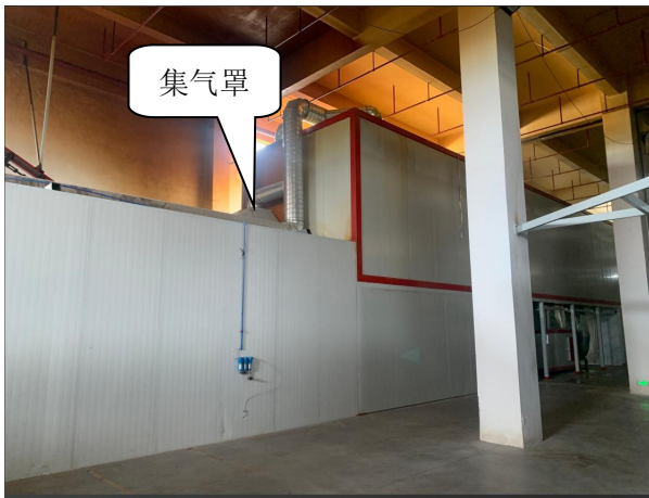
电泳车间干燥炉集气罩
