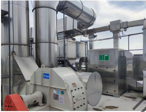
电泳车间废气排放口 FQ-6270-2
