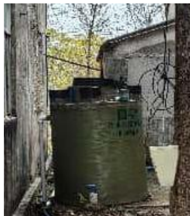
一体化污水处理设施
