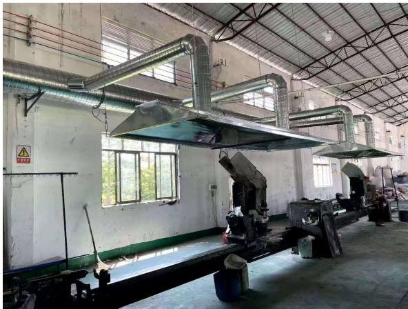
废气收集照片
