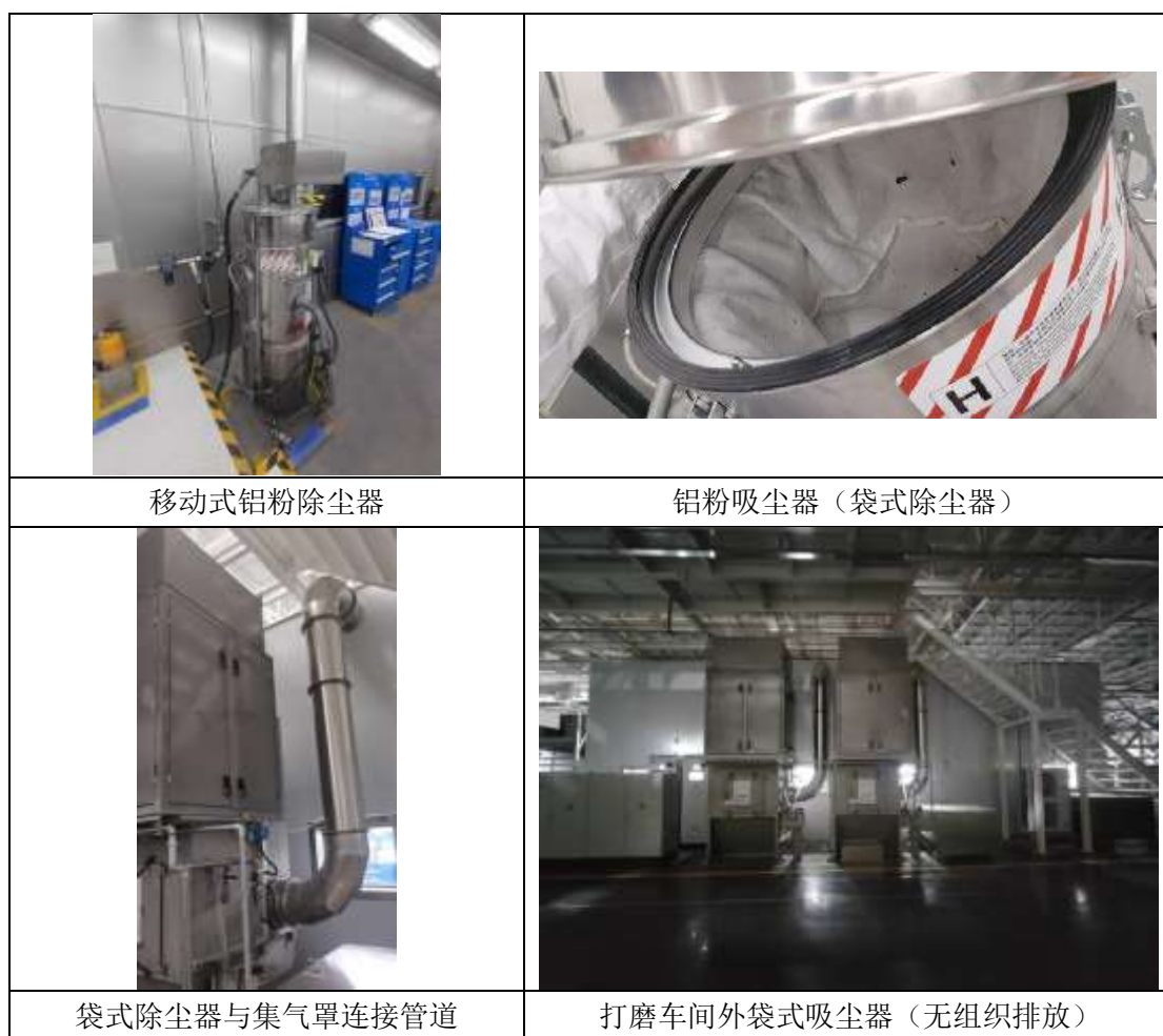
图 4.4-15 打磨车间打磨粉尘处理措施
