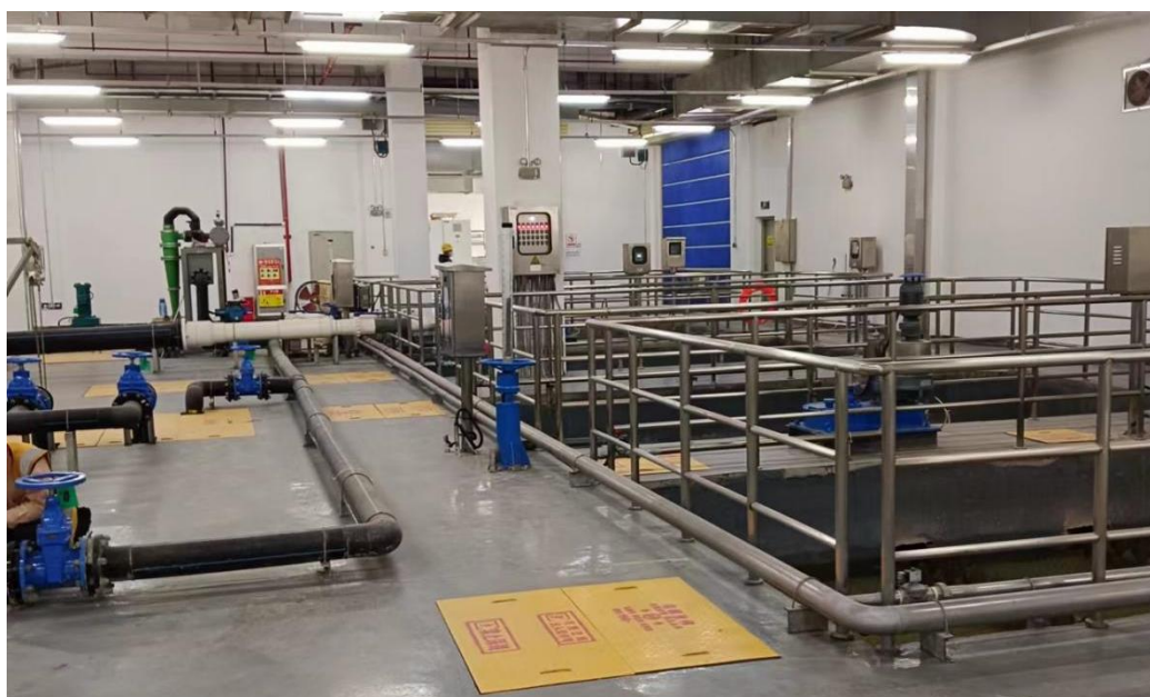
图 6.2-10 黄埔区永和北水质净化厂高效沉淀池照片
