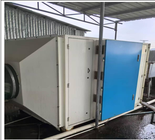
废气治理措施（二级活性炭吸附）
