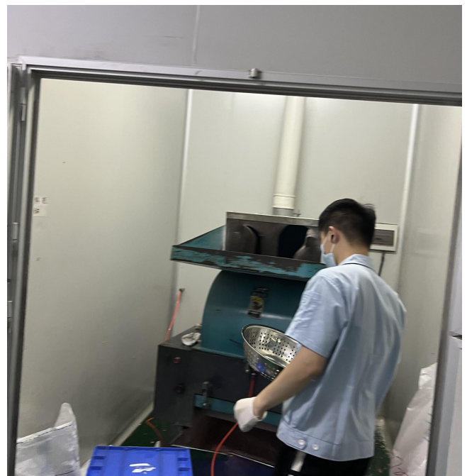
现有项目碎料机废气收集
