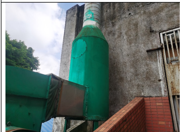
废气治理设施照片
