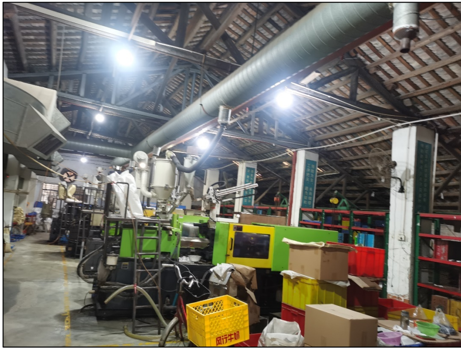
图 2.5 现有项目注塑机废气收集装置照片
