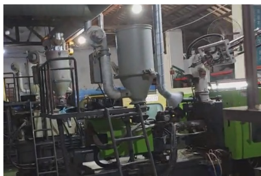
废气收集装置照片
