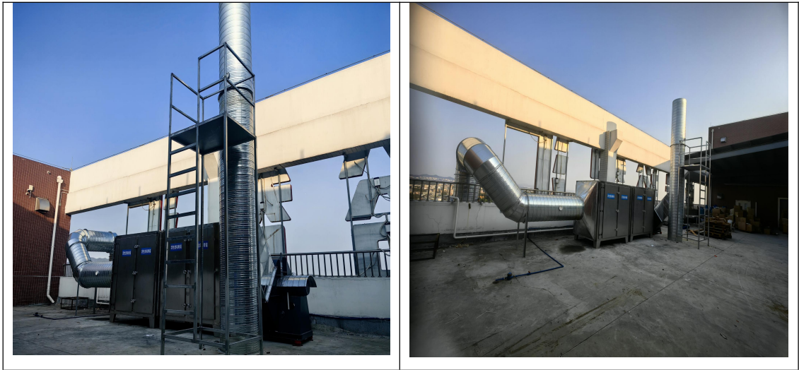
图 4-2 本项目废气处理设施
