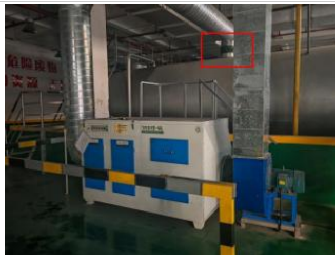
项目厂房情况-废气处理设施
