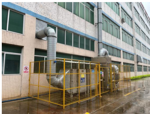
植物液喷淋+干式过滤+活性炭吸附废气设施
