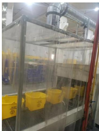
丝印机废气收集设施
