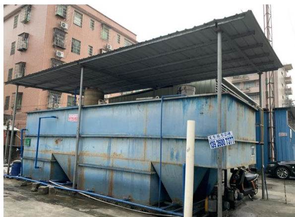
项目南侧：园区废水处理设施
