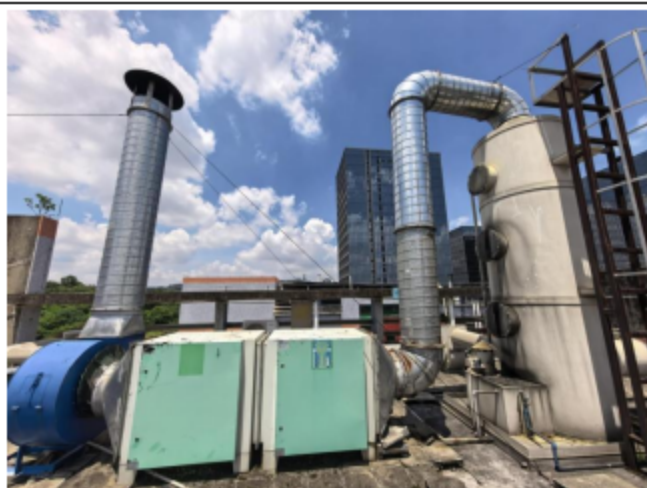
原项目“碱液喷淋塔（设除雾装置）+活性炭吸附”装置
