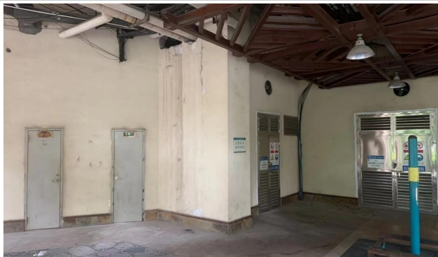
项目西面：小区机房
