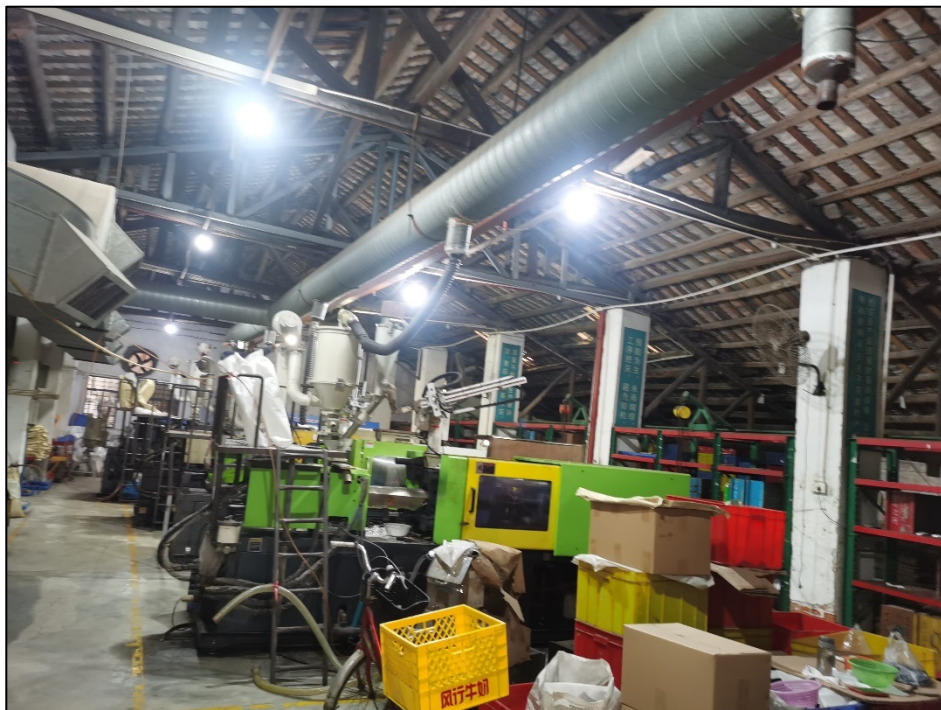
图 2.5 现有项目注塑机废气收集装置照片
