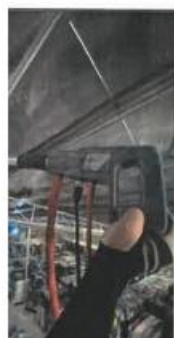
废气处理后采样口
