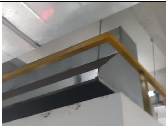
图 2-14 厂房 C1 排气筒 FQ-20270-3 收集图
