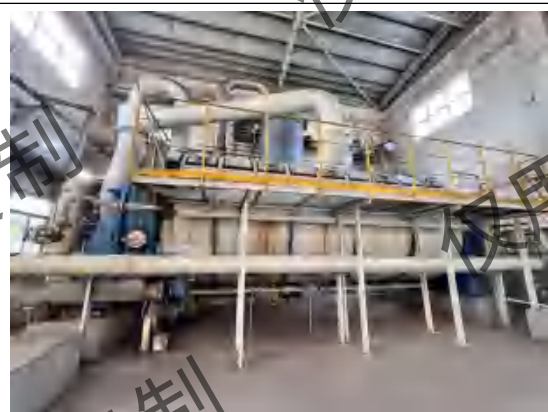
湿污泥干化车间
