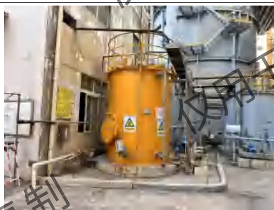
湿电除尘碱液罐区
