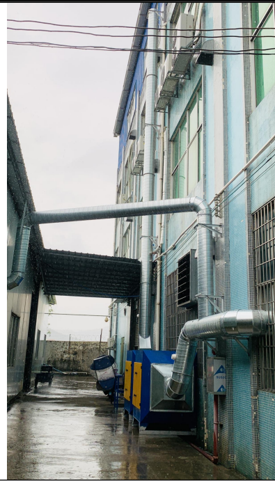
废气排气筒（DA001）
