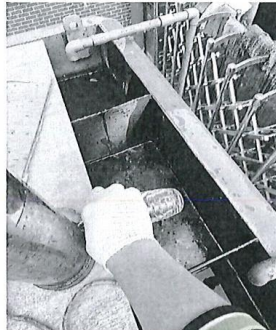
生产废水处理前采样口
