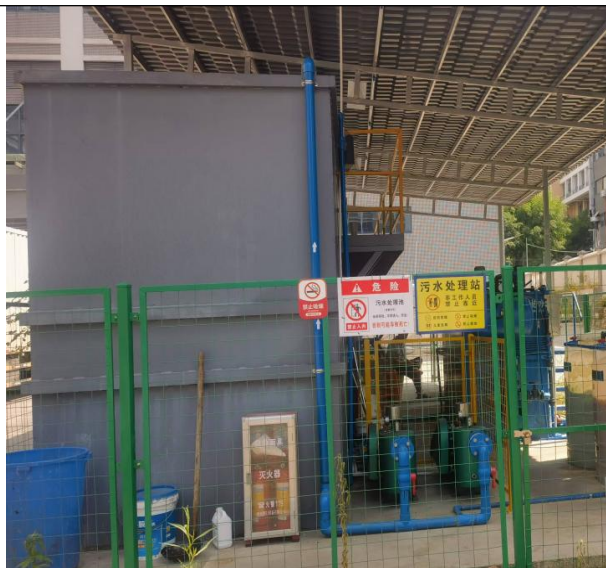
自建生产废水处理站
