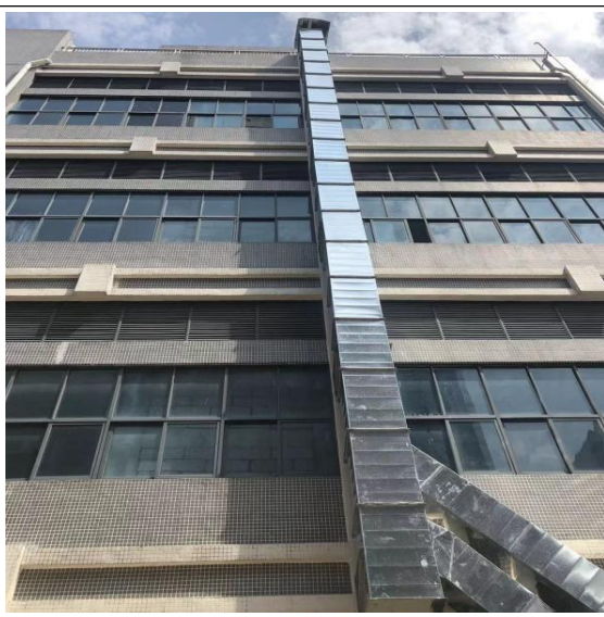
燃天然气尾气排气筒（DA001）
