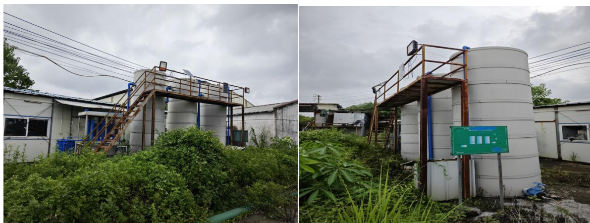
图 5-2 自建生活污水处理站照片图
