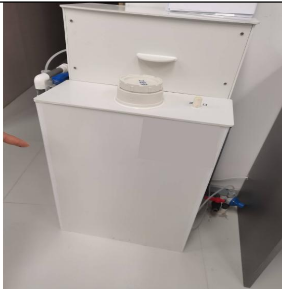
图 2-4 医疗废水处理设施照片
