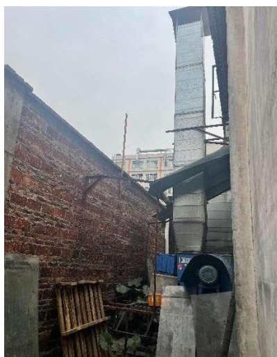
排气筒（整改前）
