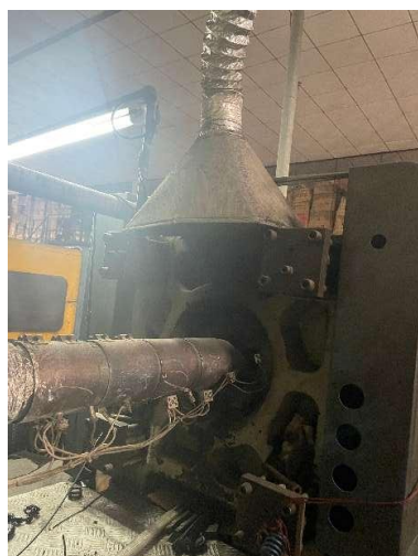
注塑废气收集方式（整改前）
