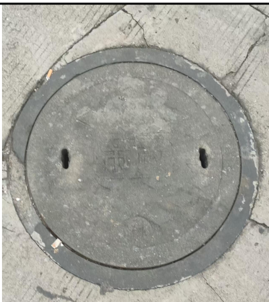
图2-2 项目园区污水井
