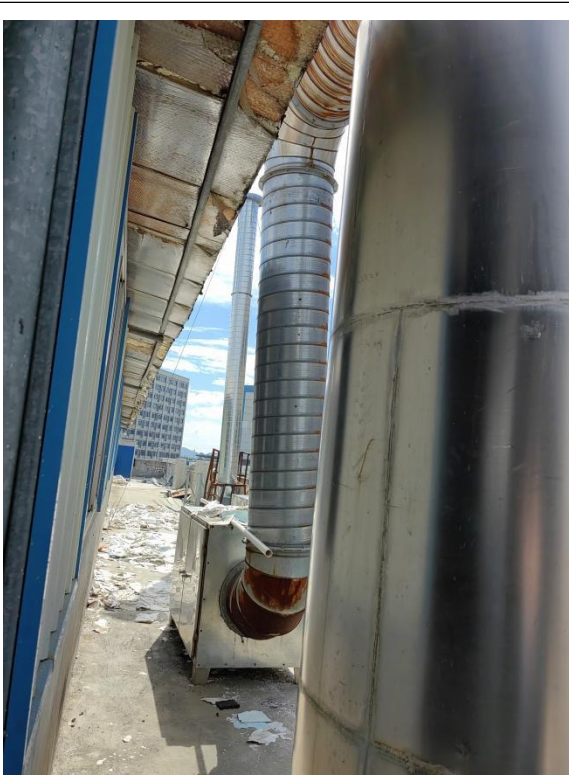
图 2-6 项目废气治理设施图片
