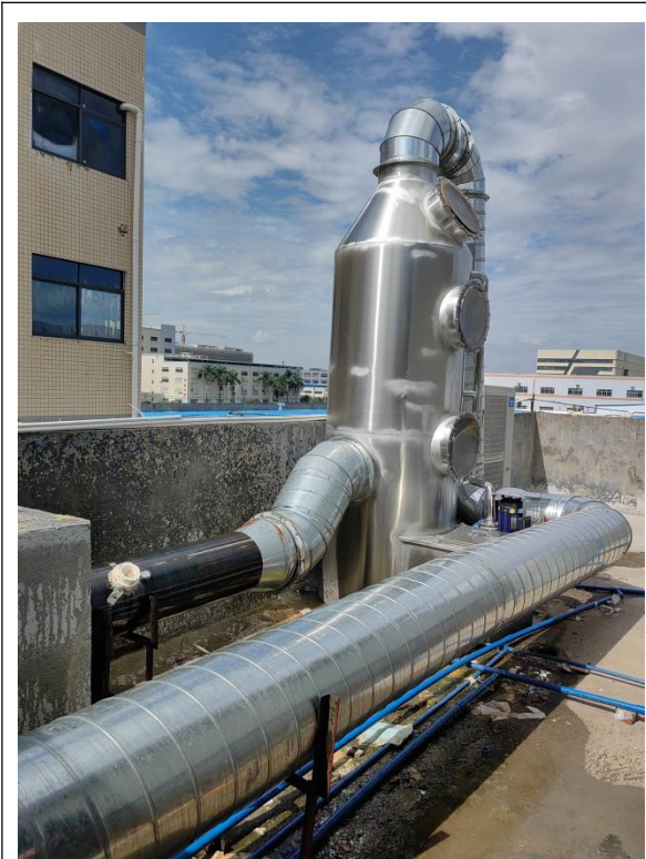
图 2-5 项目废气治理设施图片
