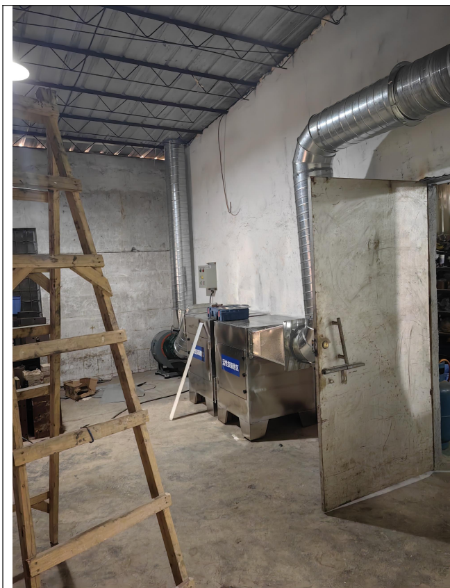
废气治理设备一二级活性炭吸附装置图
