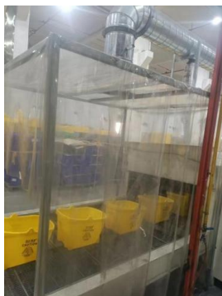
丝印机废气收集设施
