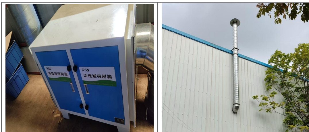
图 4-2 本项目升级改造后废气处理设施
