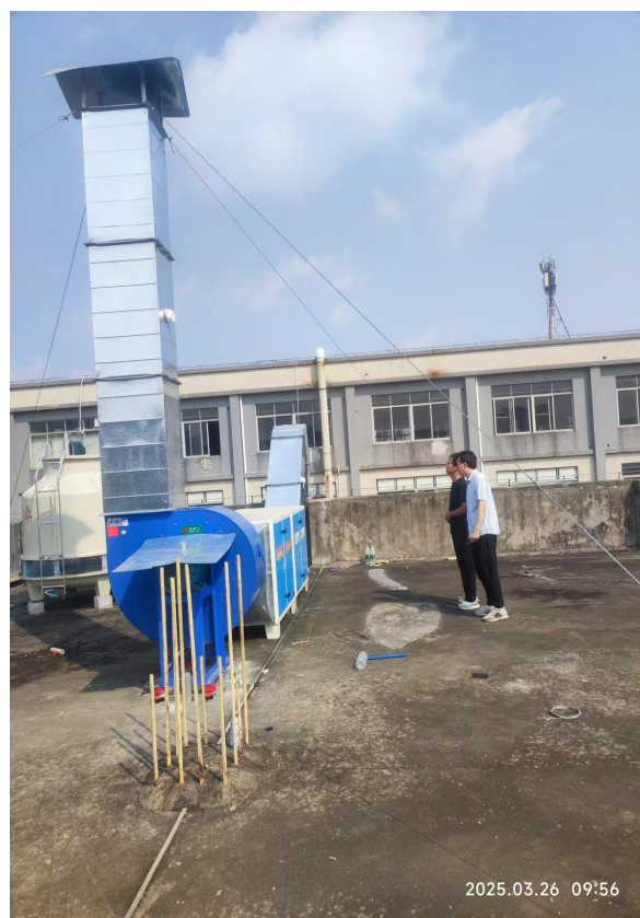
活性炭吸附装置及排气筒
