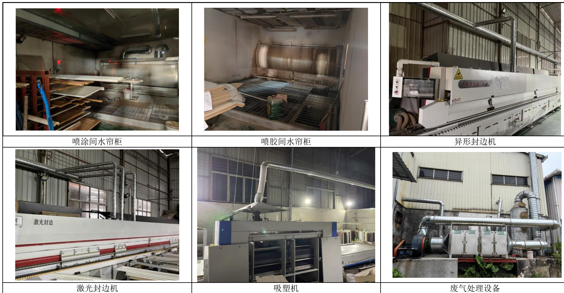
附图5. 项目内部及废气治理措施实况图
