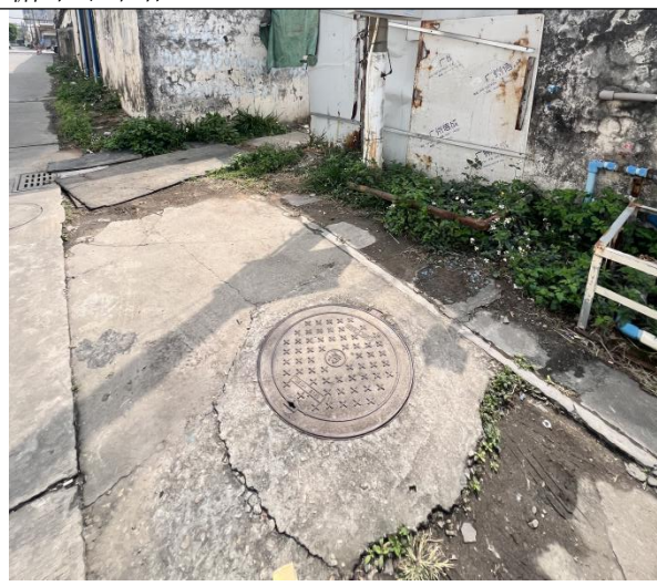
西北侧污水接驳口
