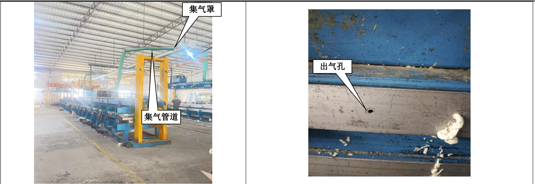
图 4-1 项目发泡废气收集情况
