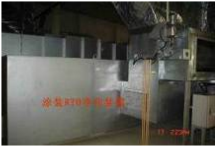
RTO 燃烧装置
