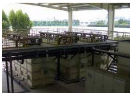
回用水站过滤池
