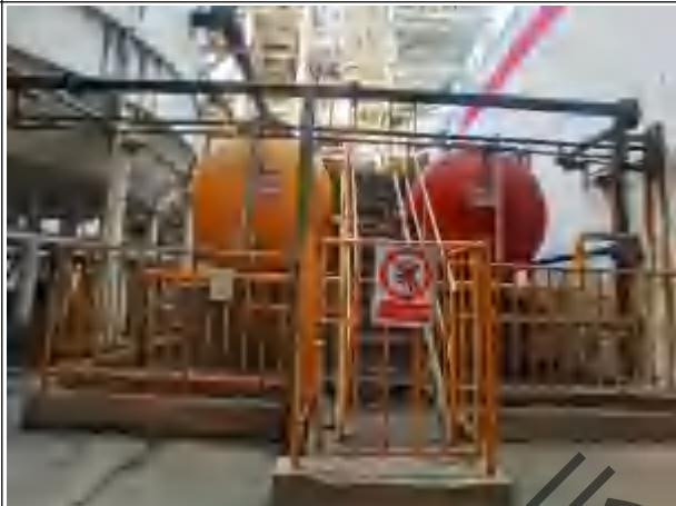
精处理酸碱储罐
