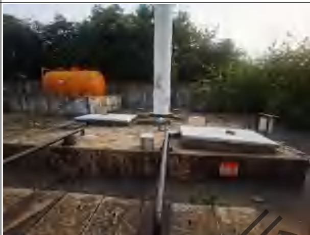
埋地事故油池
