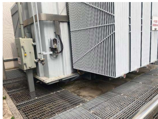
#1 主变下方挡油设施
