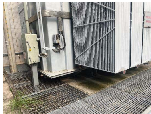
#2 主变下方挡油设施
