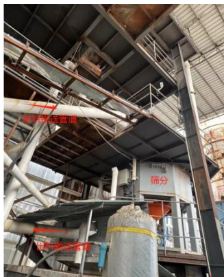
项目生产设备进出料及生产设备情况
