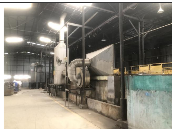
原项目前处理酸雾配套的碱液喷淋装置
