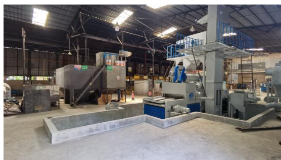
原项目生产废水配套的预处理装置（已停用）
