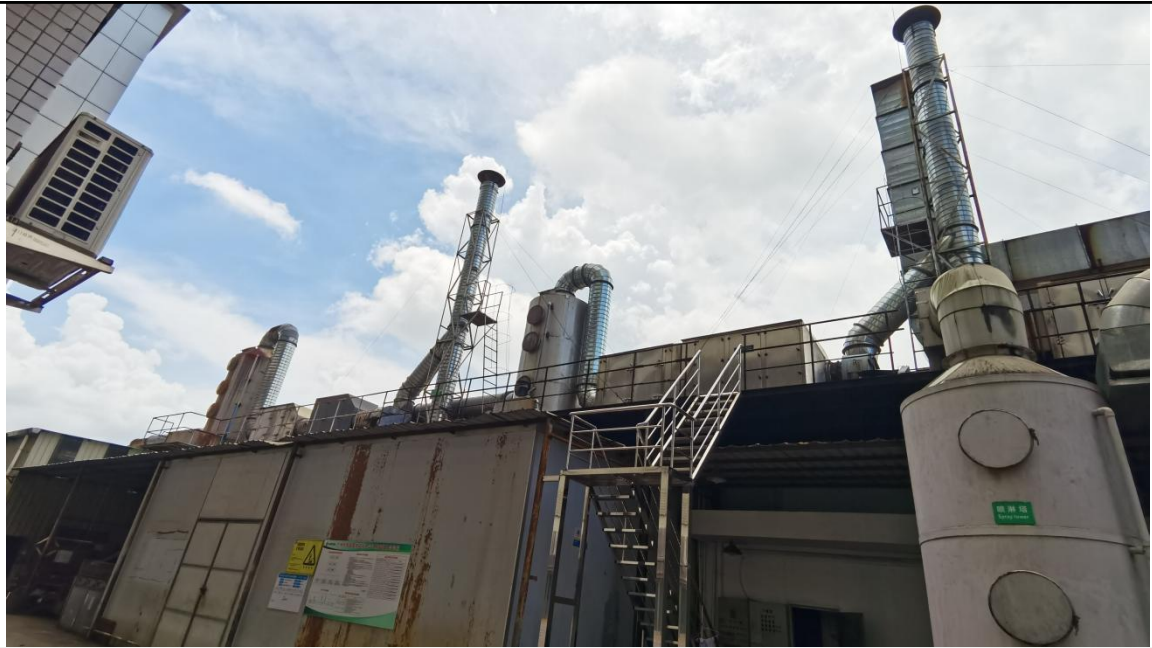
原项目喷漆浸油烘干废气（DA-003）、喷粉固化废气（DA-004）和喷漆浸油废气（DA-005） 配套的水喷淋+二级活性炭吸附装置
