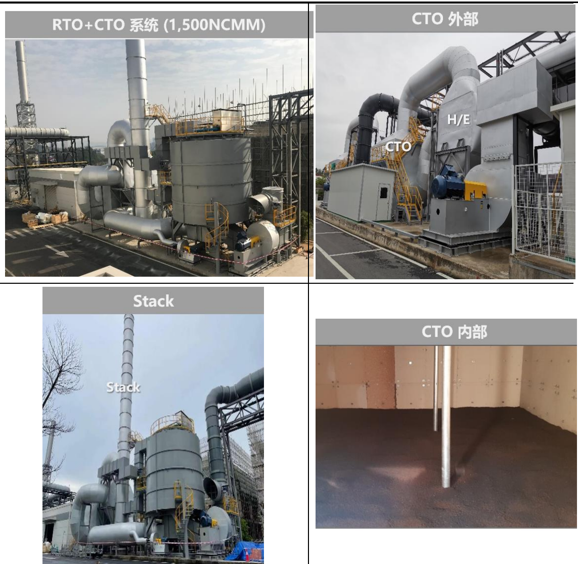
图 4-11 现有项目 RTO+CTO 处理措施现场实景图
