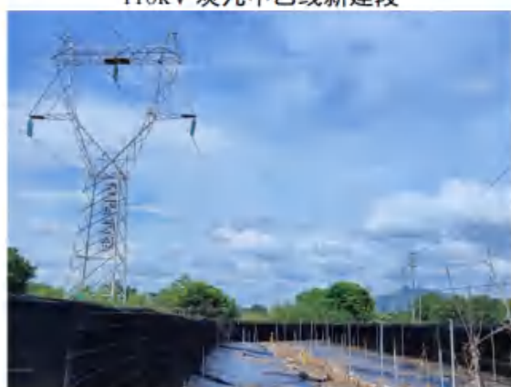
110kV 炭白线新建段
