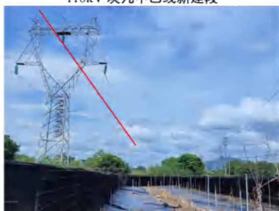
110kV 炭白线新建段
