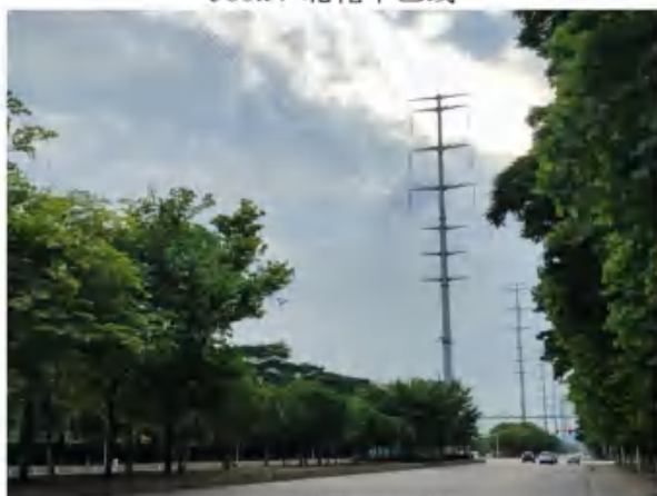
220kV 炭车甲乙线
