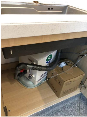
图 2-5 污水处理设施照片
