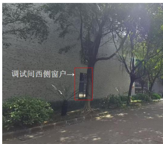
图 10-4 调试间西侧窗户现状图
