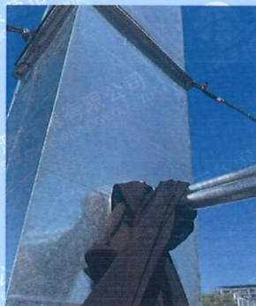
有组织废气排放口
