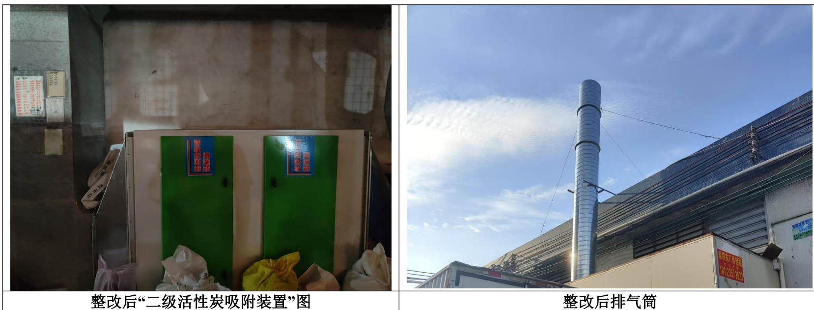
附图 19 企业目前已完成整改的废气治理设施图
