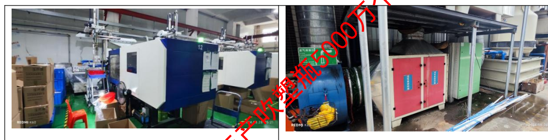
图 2-5 现有项目注塑废气收集治理设施现场图
