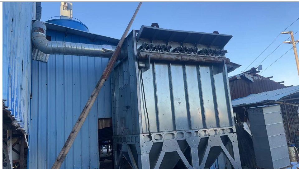
粉尘处理设施
