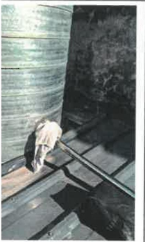
2 废气处理前采样口
