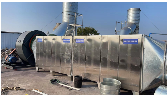
废气处理设施-TA005 二级活性炭吸附
