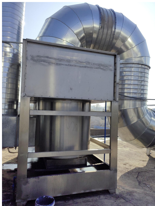
废气处理设施-TA005 水喷淋（顶部设干湿分离球）
