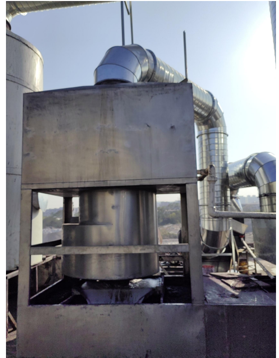
废气处理设施-TA002 水喷淋
