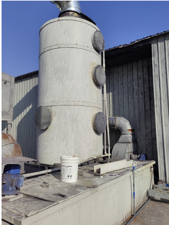
废气处理设施-TA001 水喷淋
