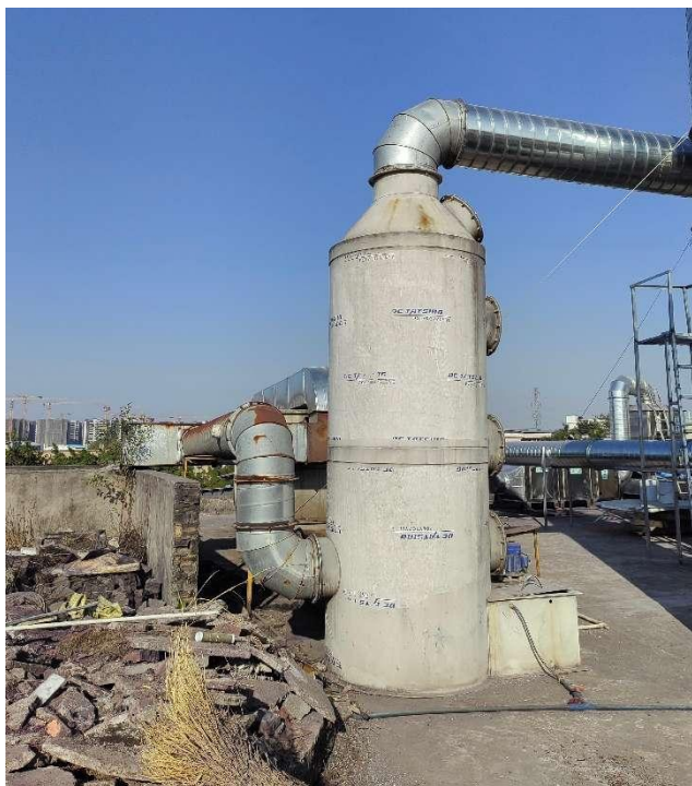
废气处理设施-TA003 水喷淋
