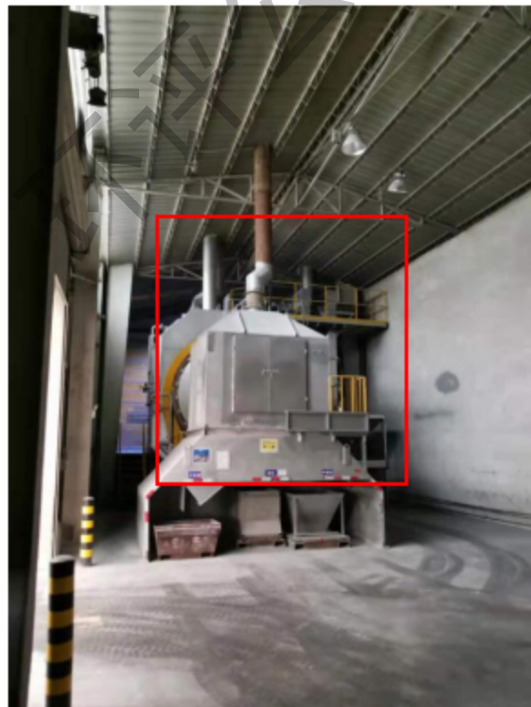
图 9.2-4 灰搅废气收集罩现场情况
