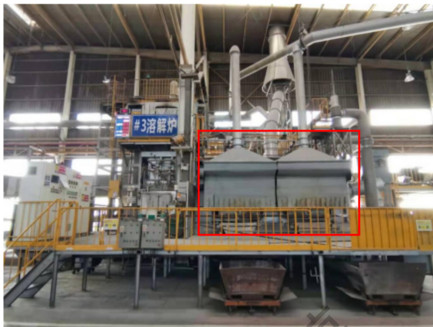
图 9.2-3 3#熔炼炉废气收集罩现场情况
