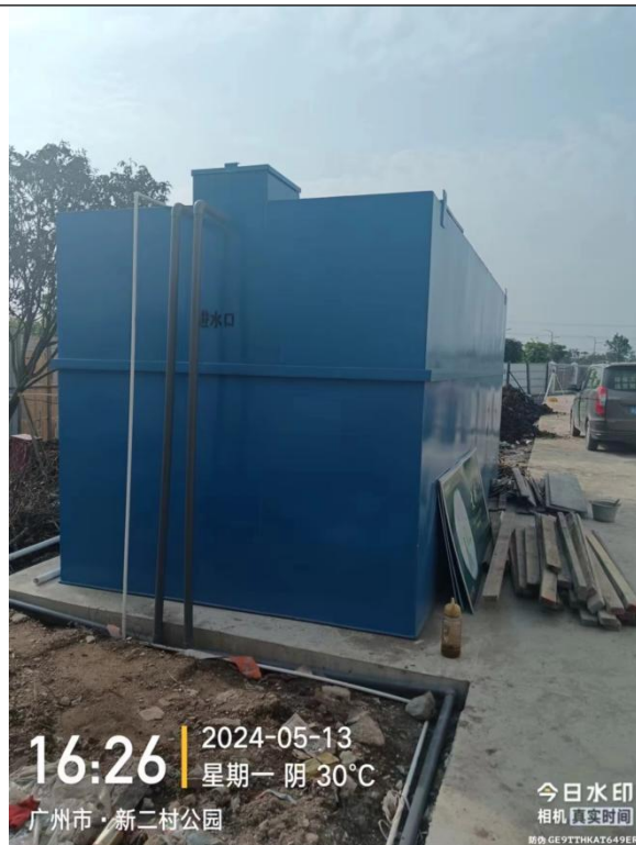
广州西江鸿盛环保科技有限公司生活污水处理设施（混凝沉淀+A/O）
