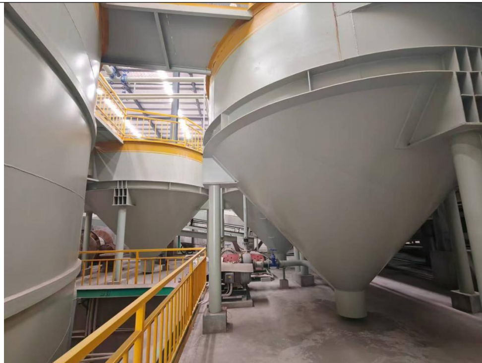
广州西江鸿盛环保科技有限公司生产废水处理设施（三级沉淀池）
