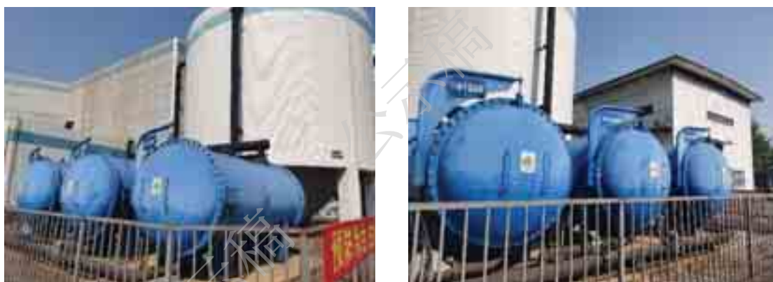
图 3.12-7 含煤废水处理系统现状照片
