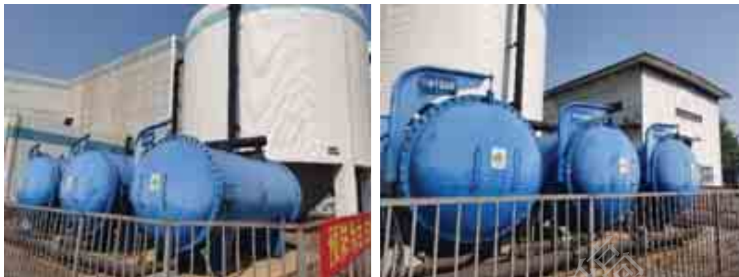
图 8.2-5 含煤废水处理系统现状照片
