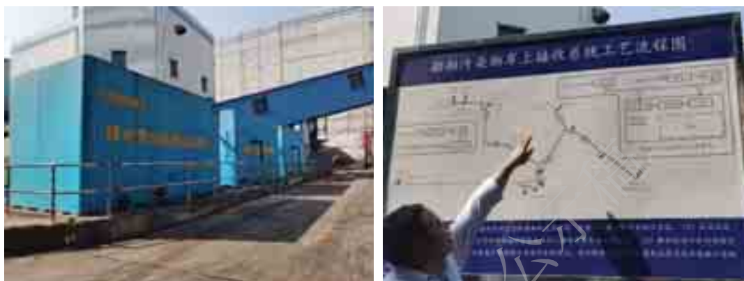
图 8.2-3 含油废水处理站现状照片
